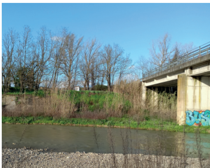
Nuovo ponte di San Vincenzo (spalla destra): specchi di difesa sponda - ultimo spezzone della traversa
